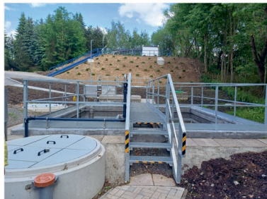
Modernizace a intenzifikace ČOV
