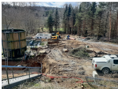
Modernizace a intenzifikace ČOV
